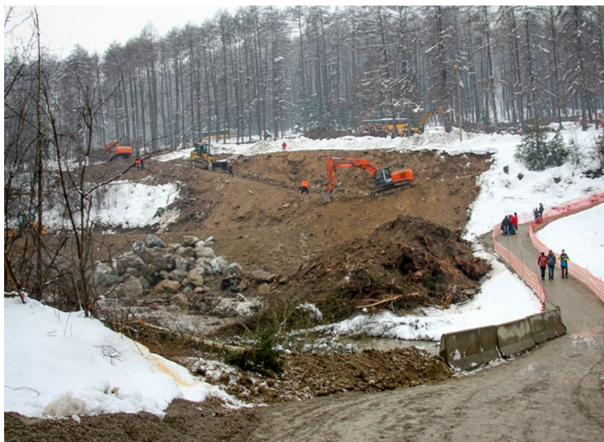
..... 📷 Gennaio 2014, frana sulla strada statale tra Sluderno e Tubre
